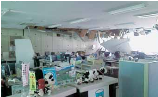
(本所 天井崩落状況)
