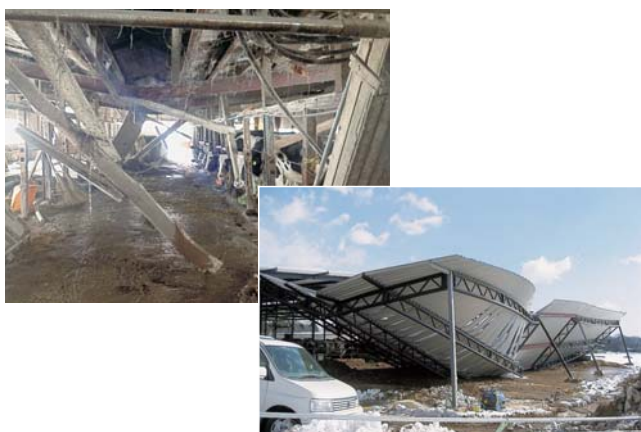
被災の一部より
